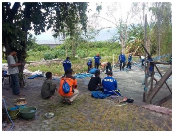
Kegiatan membangun Rumah Bersama Relawan, kolaborasi Kappala Indonesia, Gusdurian, Pramuka Peduli, Pusat Studi Manajemen Bencana UPN "Veteran" Yogyakarta, Detasemen 87 dan Komnas HAM Perwakilan Palu
