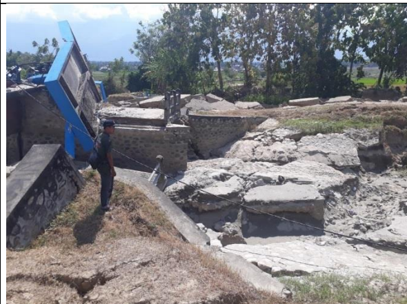
Tim Assessment melakukan pengamatan dampak gempa pada infrastruktur air dan irigasi di Kabupaten Sigi
